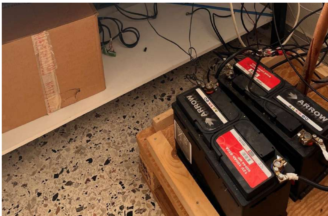
Σχ.33-3 Μπαταρίες φωτοβολταϊκού συστήματος.
